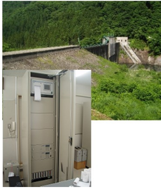
宮川ダムと管理所に設置した テレメータ監視装置
