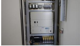
更新した水位計の保安器盤、無停電電源盤、水位計復調器
