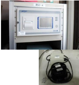
設置された計測震度計処理部(上)と計測部(下)
