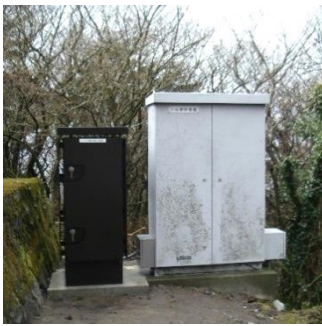
仁田峠設置の屋外筐体
