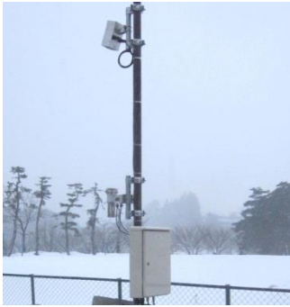
設置した積雪観測装置
