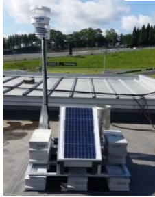
設置したPOTEKA
