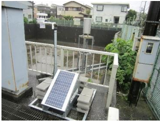
設置されたPOTEKA
