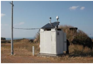
硫黄島に設置された火山観測テレメータ装置
