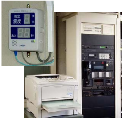
警報ユニット端末と放送設備
