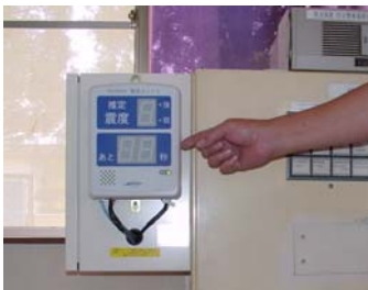
守衛室に設置された警報ユニット
