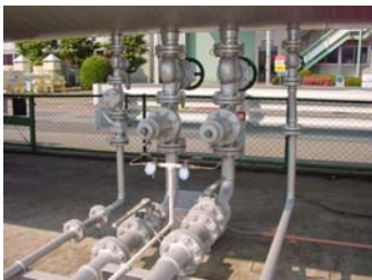
工場内の緊急遮断弁
