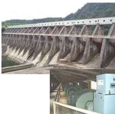
東北電力 豊実発電所ダム(写真上) とゲート開度計(写真下の右側)
