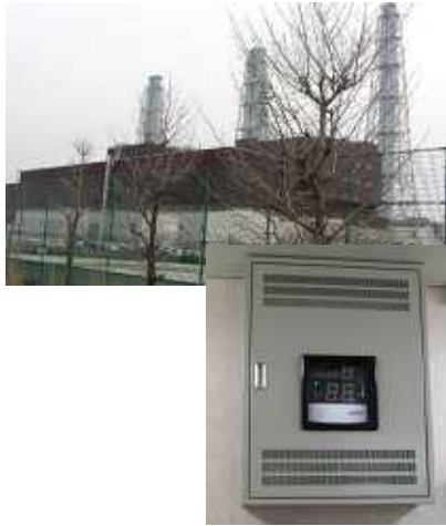
東北電力株式会社東新潟火力発電所様外観と設置されている受信ユニットS740(写真下)
