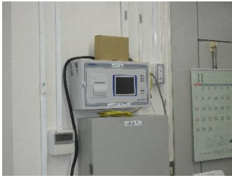
磐梯町様に設置された計測震度計
