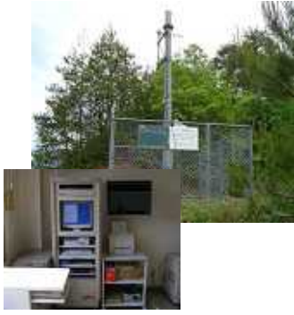
山崩れ発生予知施設観測局と監視局
