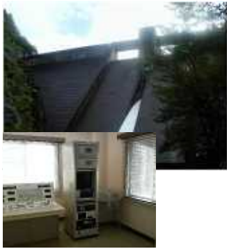
長谷ダムと管理事務所機器室に設置された地震観測システム計測震度計
