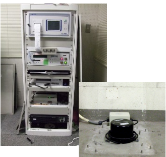
計測震度計システムと 計測震度計計測部(右下)
