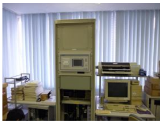
須野ダム管理事務所機器室に設置された計測震度計システム
