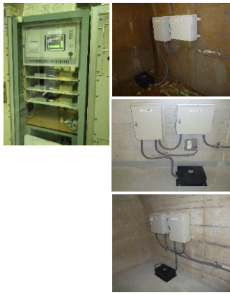
データ処理装置(左)と地震計(右) (上から、クラウドトンネル、堤頂、堤底)
