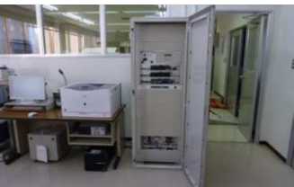
中央管理所内 ダム観測データ管理設備
