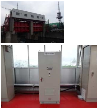
上:白旗水門全景 下:水門制御設備
