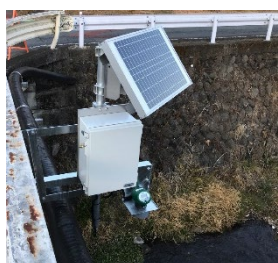
設置した危機管理型水位計
