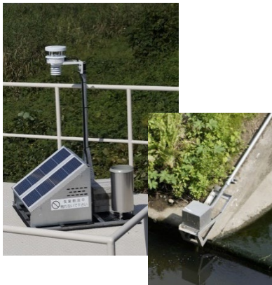
河川への流出部に設置されたPOTEKA水位計
