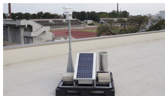
施設内にて稼働中のPOTEKA
